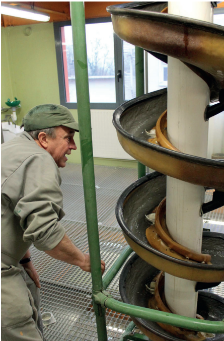
Réglage de la séparation gravitaire et centrifuge par spirale
