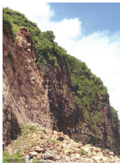
Éboulement du 24 Mars 2006, sur la route RN1 du littoral, Ile de la Réunion
